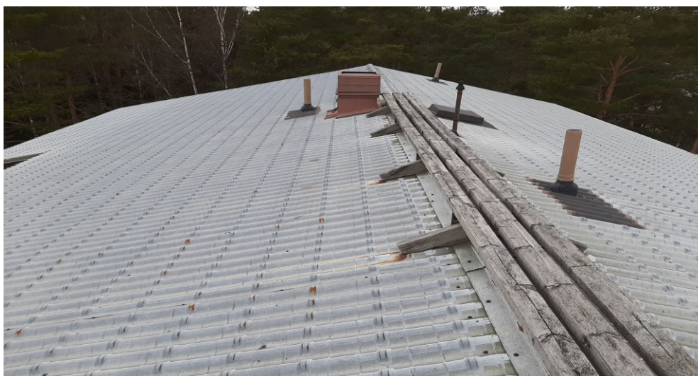
Figur 2. Gamla takbryggor och korrosion vid fästpunkterna i Sköldargård. (Tomcon Oy).
