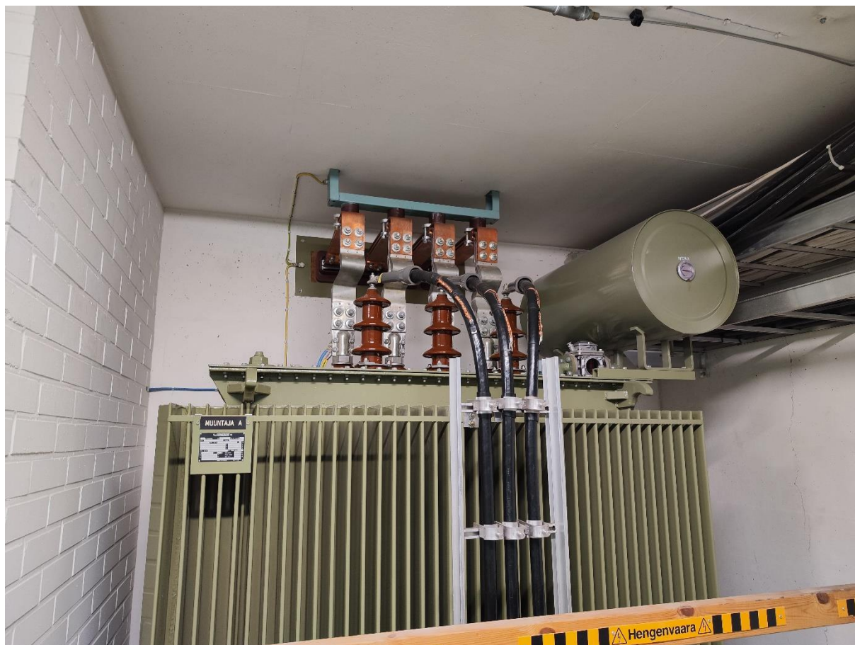
KUVA 2. Strömberg 0,4/20 kV muuntaja. (Tirkkonen, 2023)
