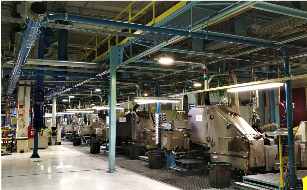
Kuva 7. Imuputkiston rakenne ennen Trimmer työstökoneita.
