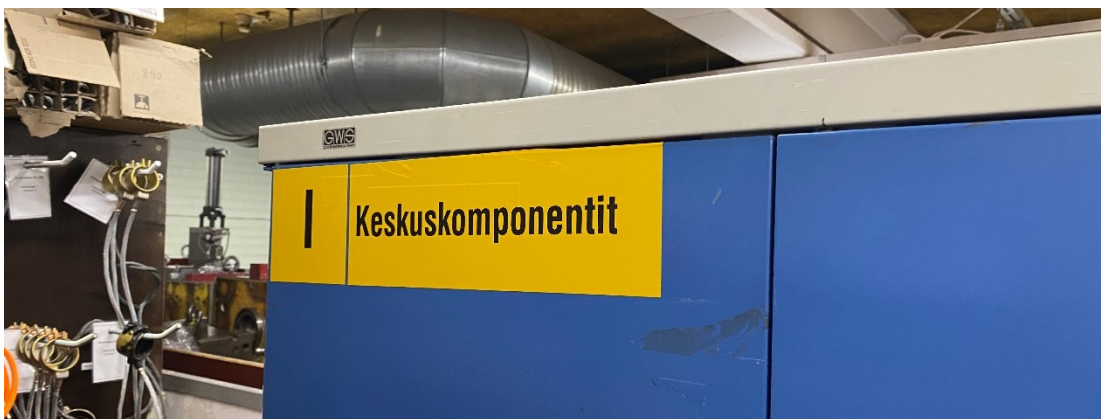
Kuva 9. Keskuskomponenttikaapin I merkinnät kaapin ovelta.
