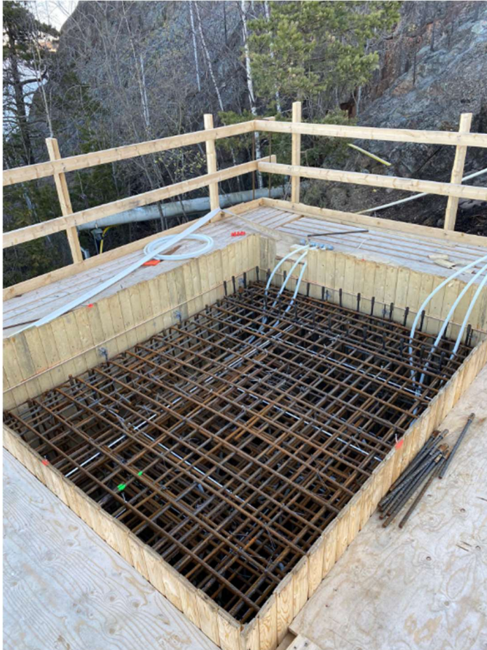
KUVA 11. Yleiskuva pilasterin sisään ja ulos menevästä putkistosta (Atte Kopra 2022)
