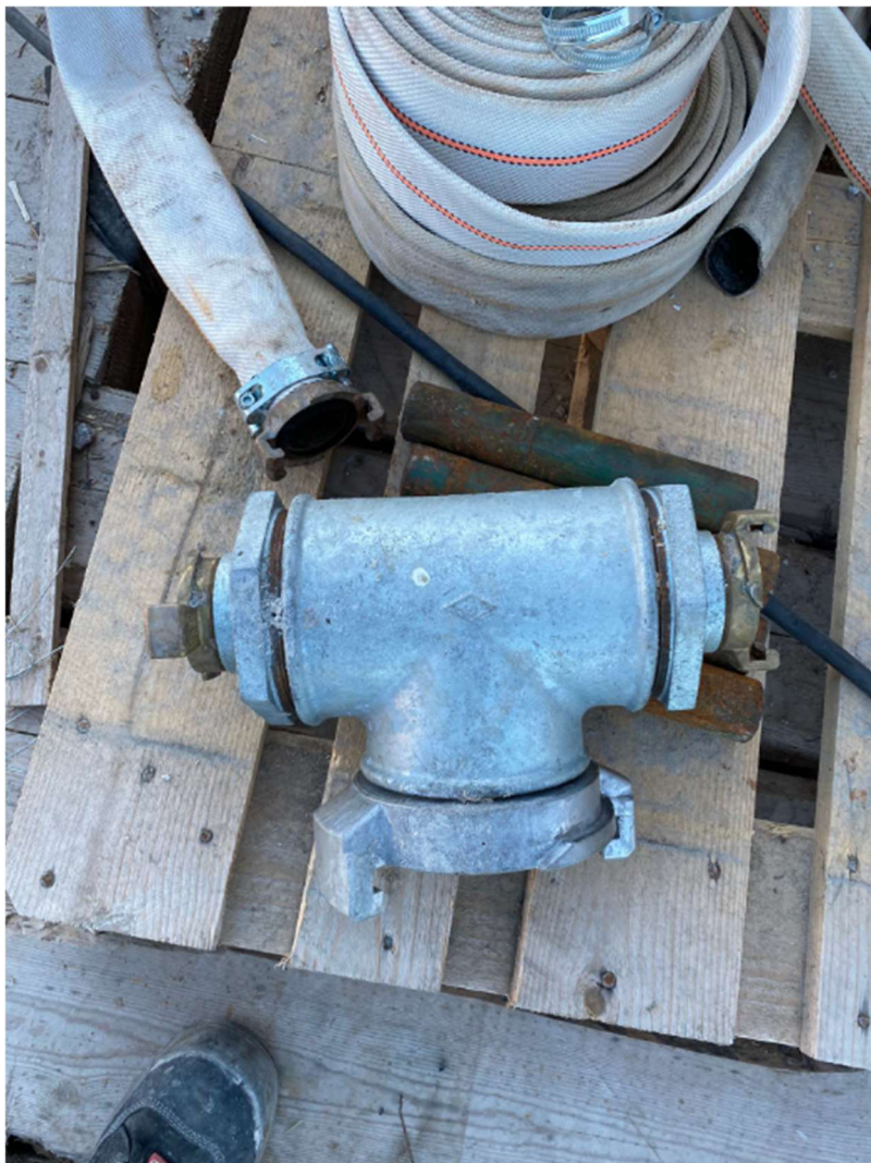
KUVA 4. T-haara, jonka alapää on yhdistetty letkulla uoppopumppuun ja ylempät haarat putkistoon, joka kiertää rakenteen läpi (Atte Kopra 2022)
