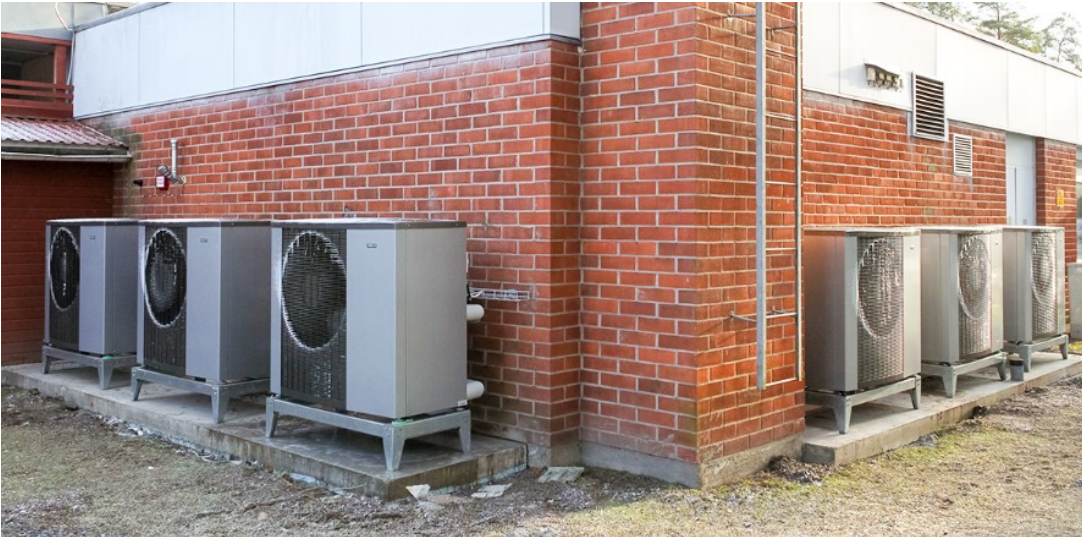
Kuva 5 Ilma-vesilämpöpumpun ulkoyksiköt (Rakennusfakta, 2020)
