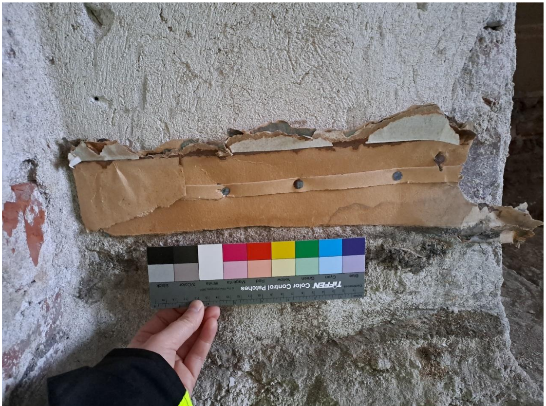
Kuva 51. Puretun huoneen 106 seinällä olleiden tapettien päällä oli pinkopahvi.
