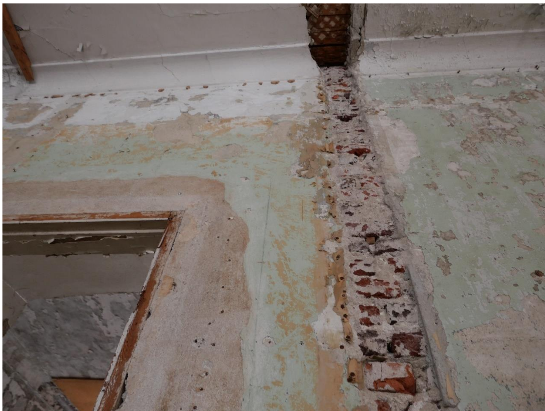
Kuva 28. Naulajono seinässä ja koristelistan alla kertoo pinkopahvin reunoista. Seinällä olevat keltaiset jäljet ovat rappaukseen kiinnitettyä paperia. Tiilijonon kohdalla on ollut väliseinä erottamassa oikealla puolella ollut huonetta 103.
