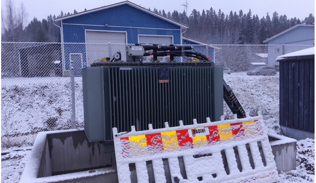
KUVA 2. 2 MVAR:n kompensointikuristin on tilantarpeeltaan puistomuuntajan luokkaa. (Toni Tarvainen, 2022)
