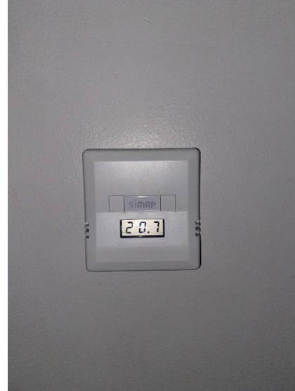
KUVA 1. Kohteeseen asennettu Simap Opticontrol-lämmönsäätöjärjestelmän huoneanturi.
