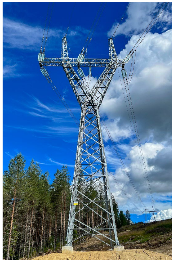
KUVA 9. Vapaasti seisova teräsrakenteinen 110 kV:n pylvä
