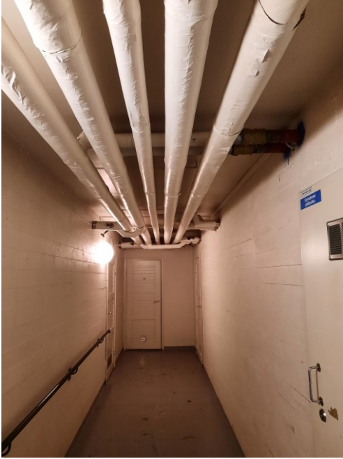
KUVA 9. Lämmönjakohuoneesta lähteviä käyttövesi- ja lämmitysjohtolinjoja.
