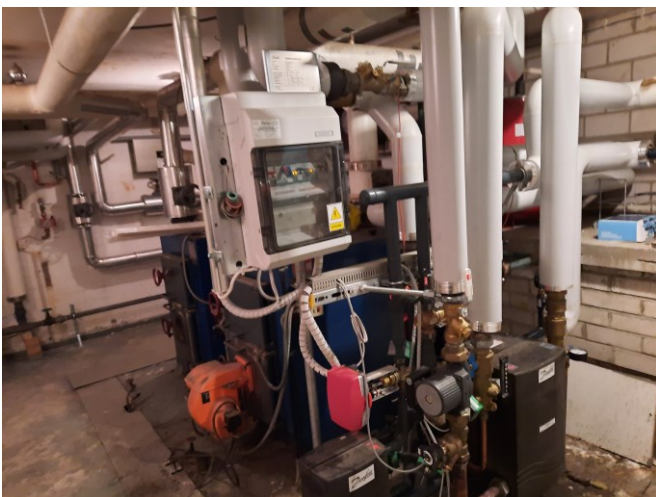
KUVA 11. Vuonna 1996 uusittu lämmönvaihdin.
