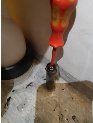
KUVA 13. Kiinteistön alkuperäiset vesi- ja viemärijohdot ovat pahasti tukossa (6 mm meisseli ei mene enää läpi johtoon).
