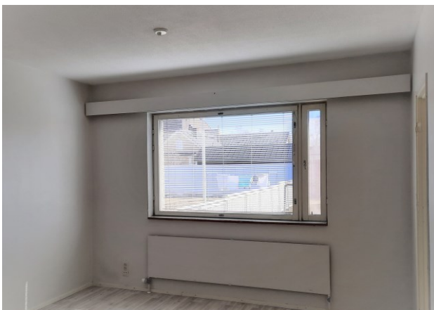
KUVA 7. Asunnon olohuoneen ikkuna, josta puuttuu tuloilmaventtiili.
