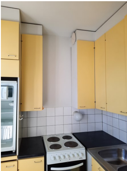
KUVA 6. Asunnon keittiön poistoilmaventtiili ja valaistusta.
