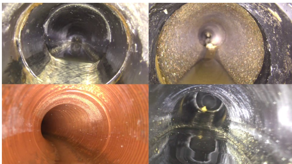
Kuva 3. Erilaisia vikoja. Ylhäällä vasemmalla vuoto saumassa. Ylhäällä oikealla syöpymää. Alhaalla vasemmalla putki kaartaa. Alhaalla oikealla viettokaltevuus.
