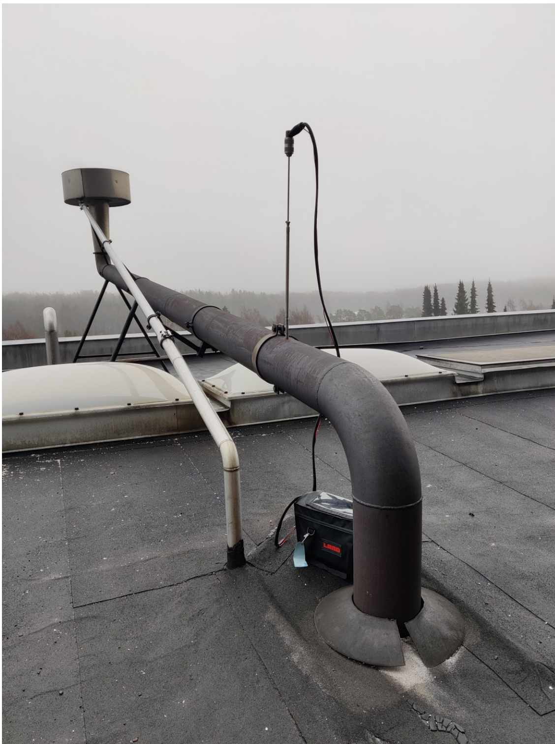
Kuva 10. Piipusta poistuvan hiilidioksidin määrän mittausta LANCOM-savukaa- suanalysaattorilla.
