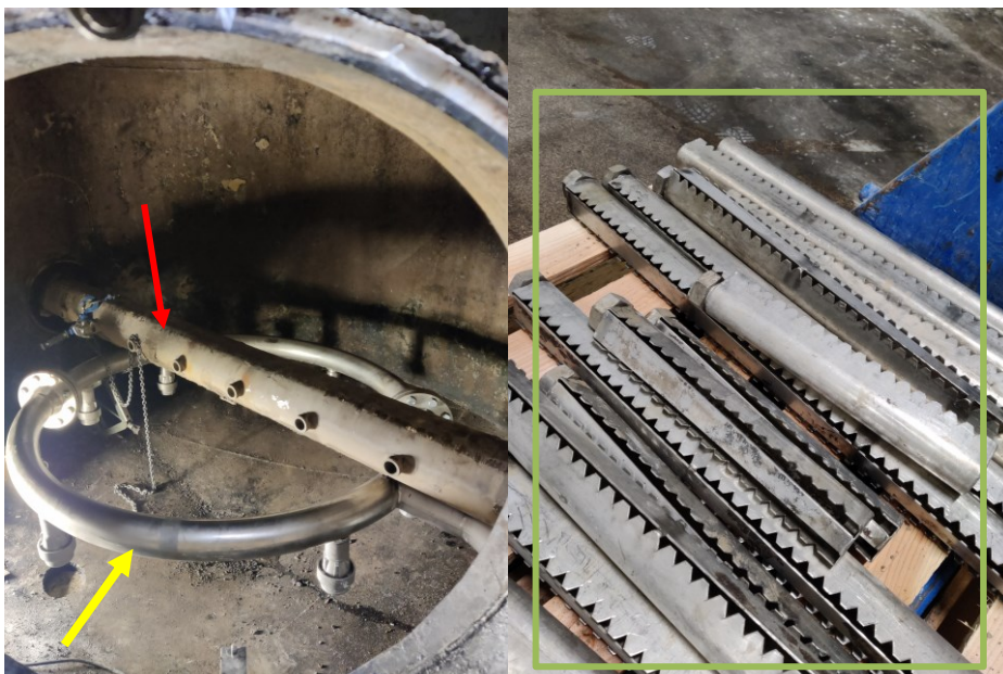
Kuva 9. Saittoreaktorin pohjalla näkyvät höyryjakorengas merkattu keltaisella nuolella, jonka yläpuolella vanha savukaasun jakoputki merkattuna punaisella nuolella, jossa on ulostuloreikiä jakolaitteille (oikealla, vihreä neliö).
