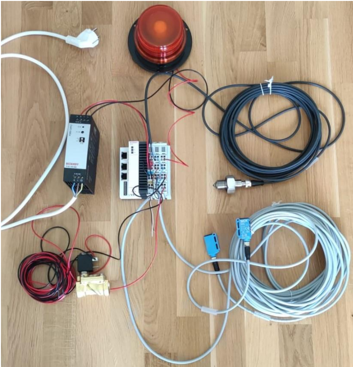
KUVA 22. Valmis asennettu automaatiolaitteisto
