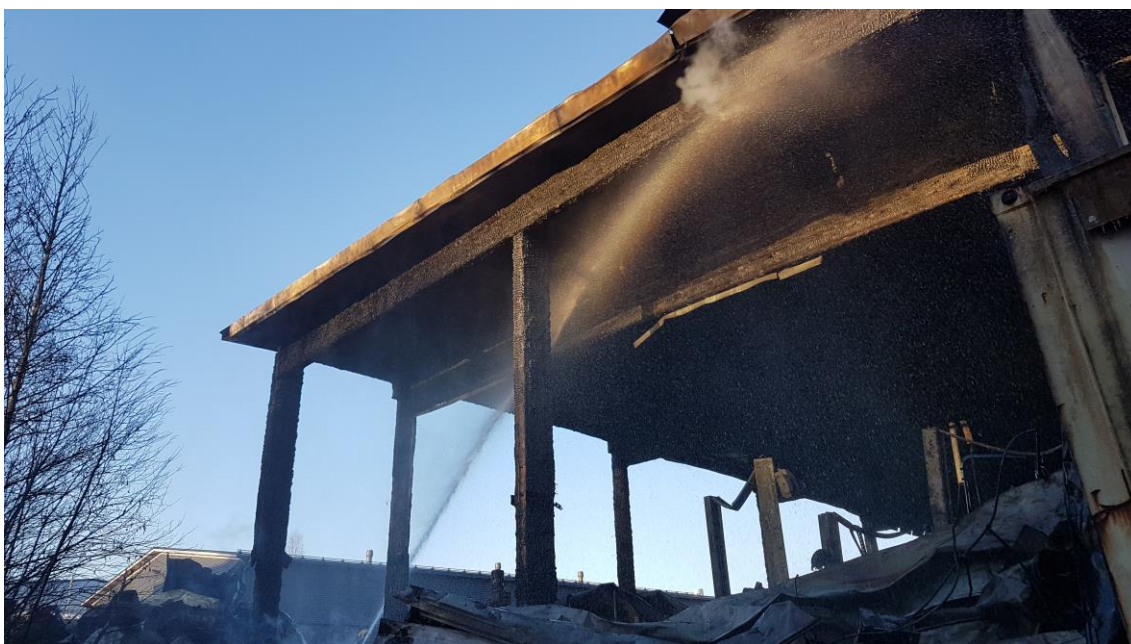
KUVA 17. Autokorjaamon liimapuurakenteet eivät sortuneet palossa (Syrjä 2023).
