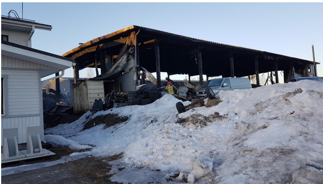
KUVA 16. Viereisen tontin palossa tuhoutunut autokorjaamo (Syrjä 2023).
