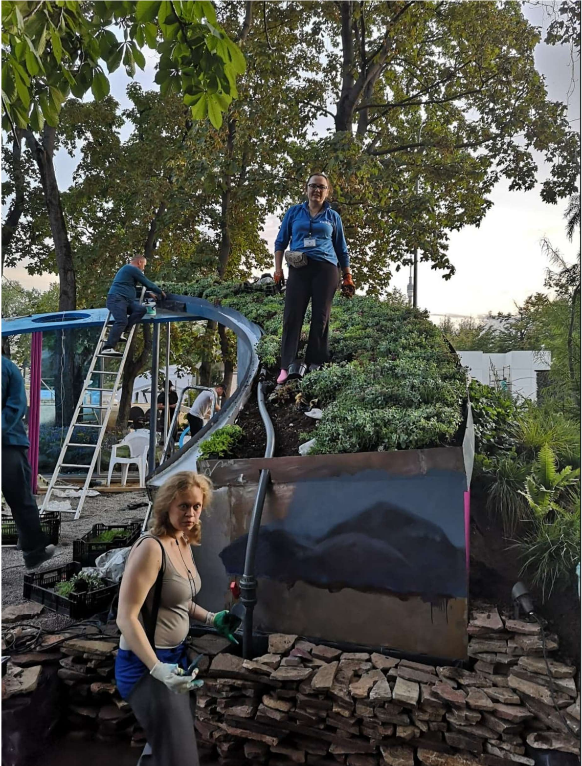
Kuva 14. Päädyn taideteos jouduttiin peittämään liuskekivillä, joilla piilotettiin vesiletku (Heidi Hannus, 2019).
