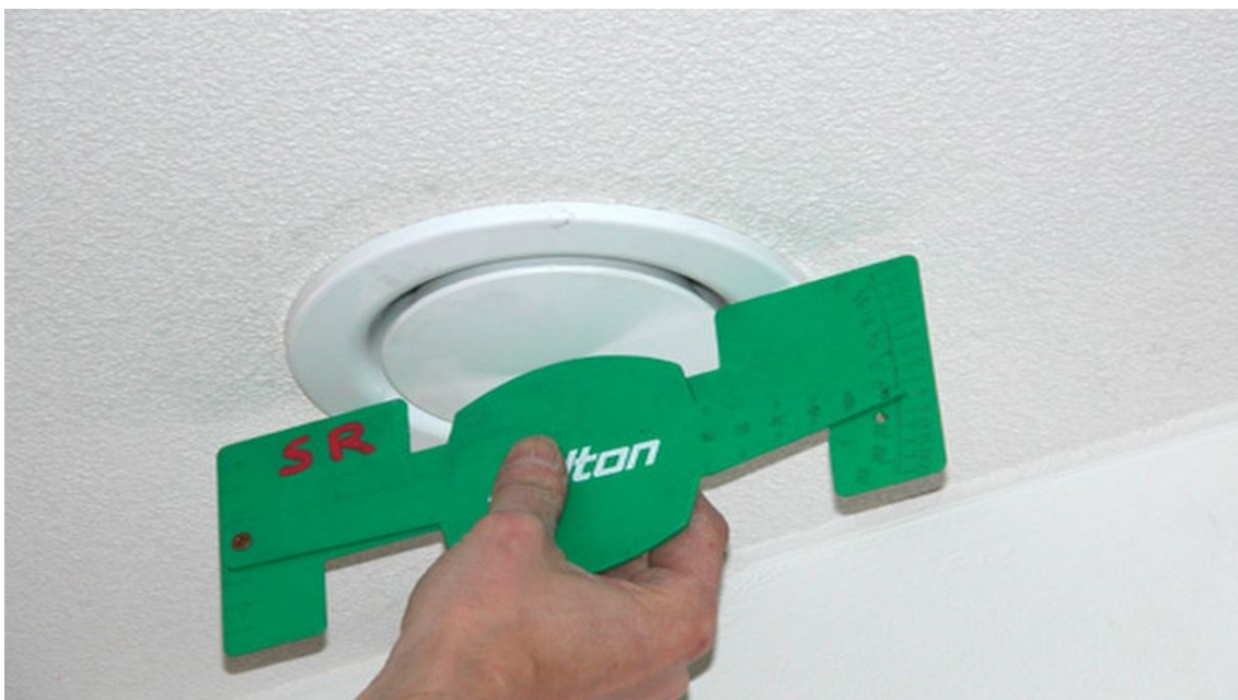
Kuva 7. Poistoilmaventtiilin aukeama mitataan rakotulkilla, joka ilmoittaa aukeaman millimetreissä. (28.)
