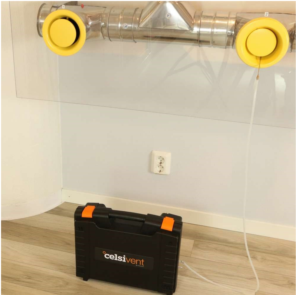
Kuva 12. Sensorcell Oy:n etäluettava paine-eromittari. Mittaustuloksia on mahdollista seurata reaaliaikaisesti nettiselaimesta. Mittarilla mitataan referenssiventtiin ilmavirtaa. (22)
