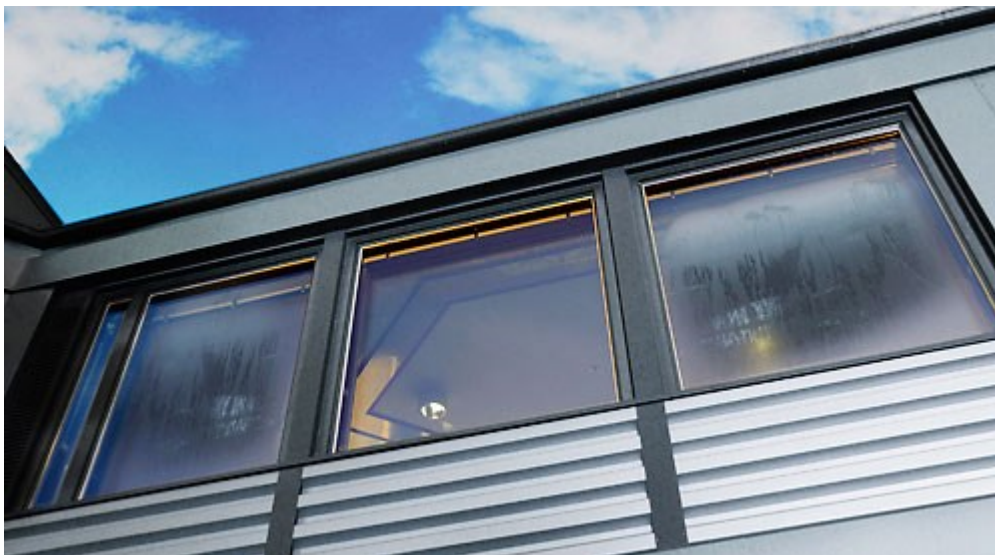
Kuva 9. Kerrostalon huurtunut ikkuna. (14)
