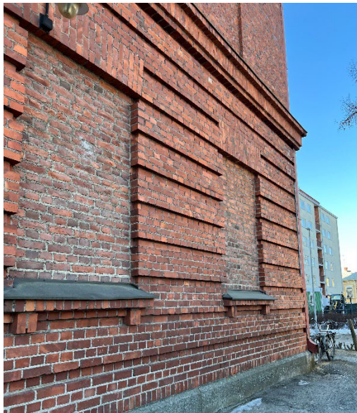
KUVA 5. Umpeen muuratut ikkunat (Kortelainen 2023)
