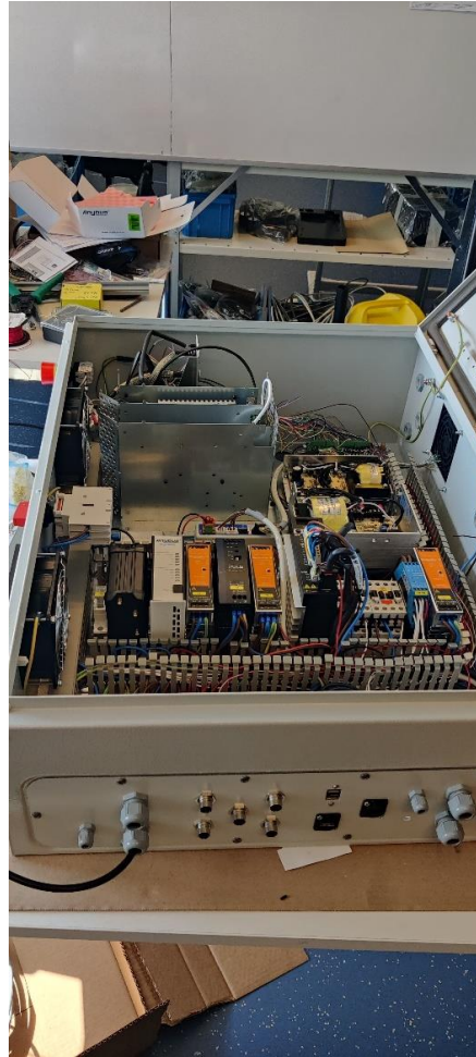
Kuva 5 Sparklike LI-sähkökaappi avattuna
