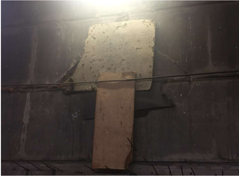
Kuva 14. Ulkoseinävaurio sisältä katsoen
