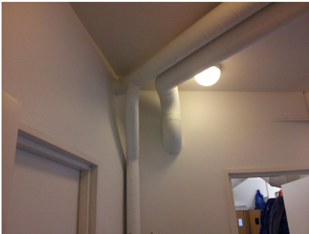
Kuva 7. Vasemmalla on kanava neuvotteluhuoneeseen, josta läpivienti alas toimistoihin. Oikealla on pukuhuoneeseen johtava kanava.
