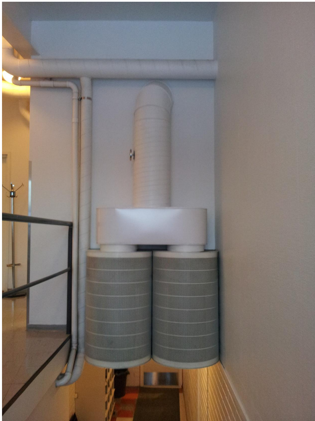
Kuva 1. Väliaikaisratkaisu ilmanpaineen tasaamiseksi.
