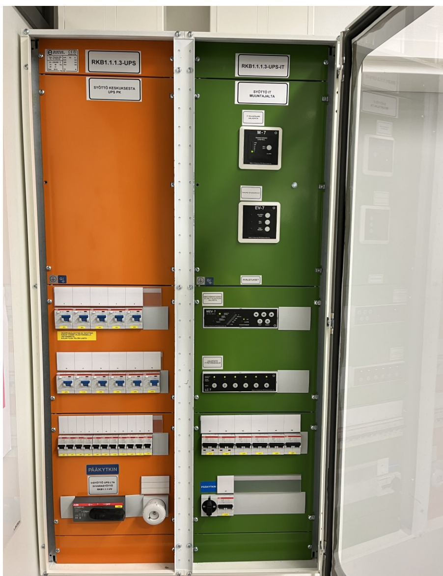
Kuva 6. UPS- ja lääkintä-IT-järjestelmän ryhmäkeskukset ryhmän 2 lääkintätalossa.
