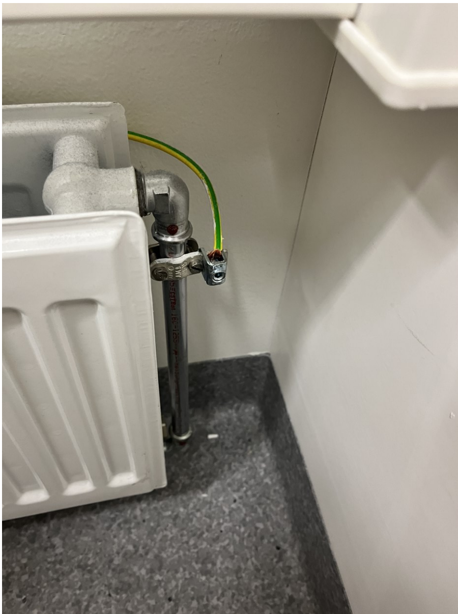
Kuva 3. Lämpöpatterin potentiaalintasaus hoituhuoneessa.
