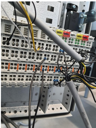
Kuva 23. Johtimet asennettuna Beckhoff KL2134 -outputmoduuliin.
