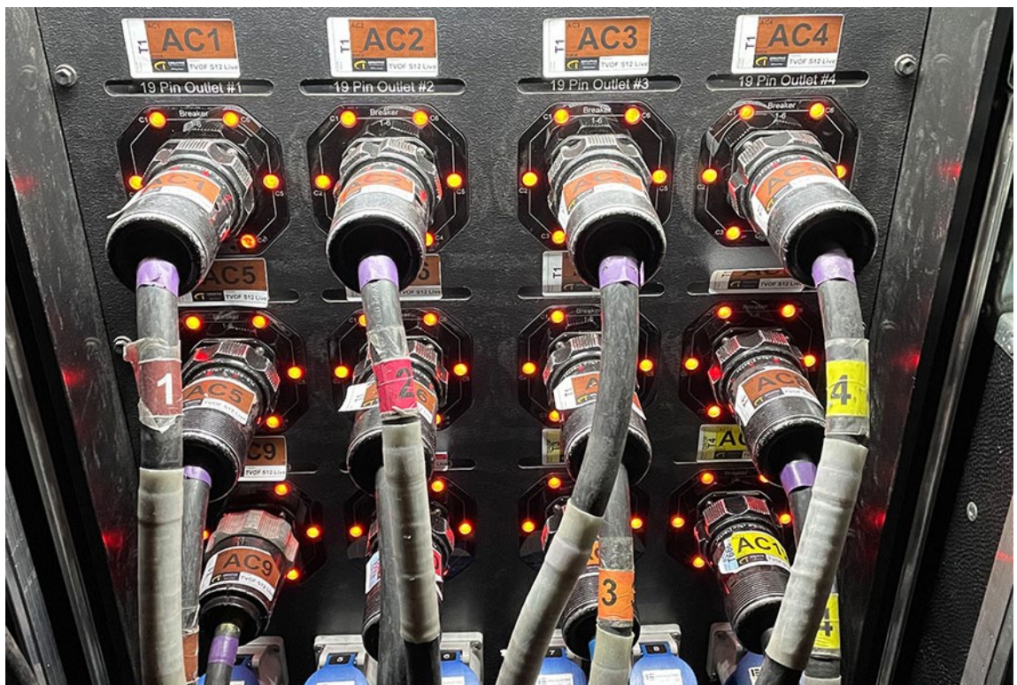
Kuva 3. Socapex-lähdöt ja kaapelimerkinnät. (Kuva Oskari Nykänen 2023)
