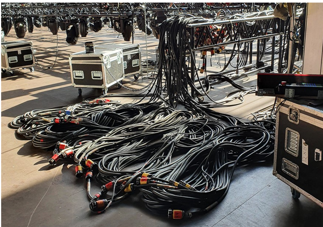
Kuva 8. Kaapelitrussi ja jönkköjä (Kuva: Walteri Wahlroos 2022)
