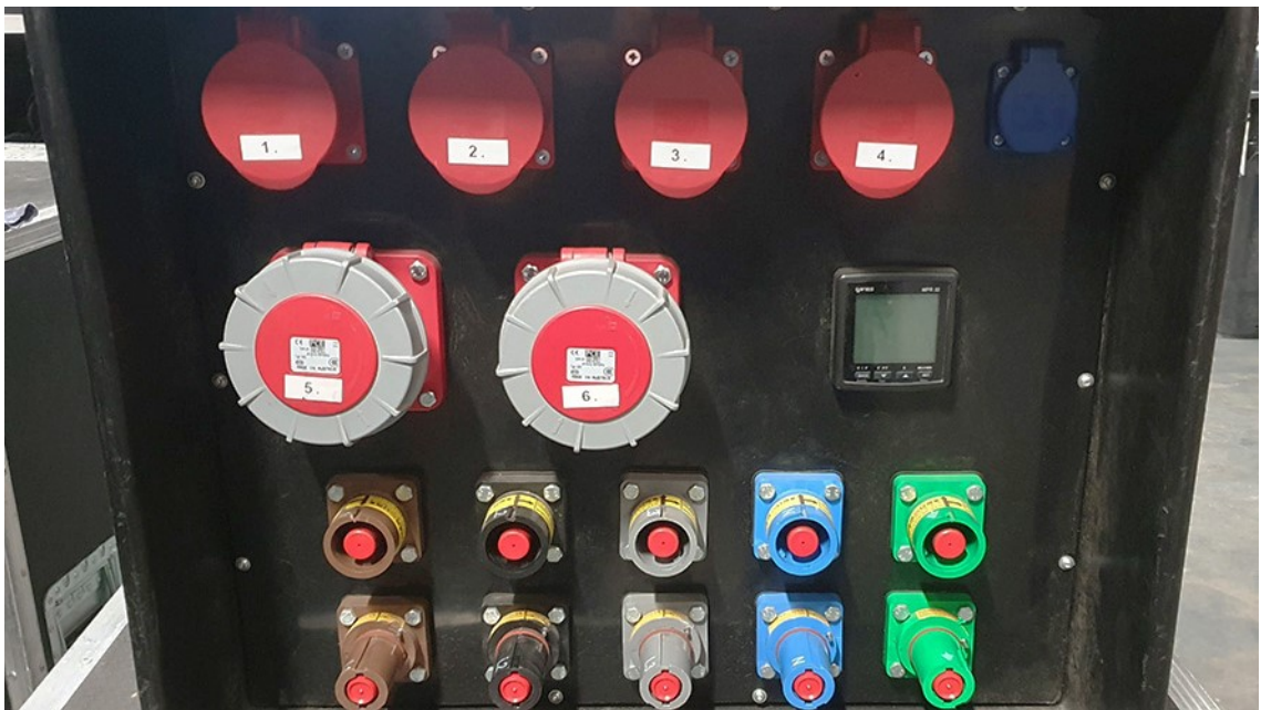
Kuva 2. Powerlock-diston kytkentäpuoli. (Kuva: Walteri Wahlroos 2023)
