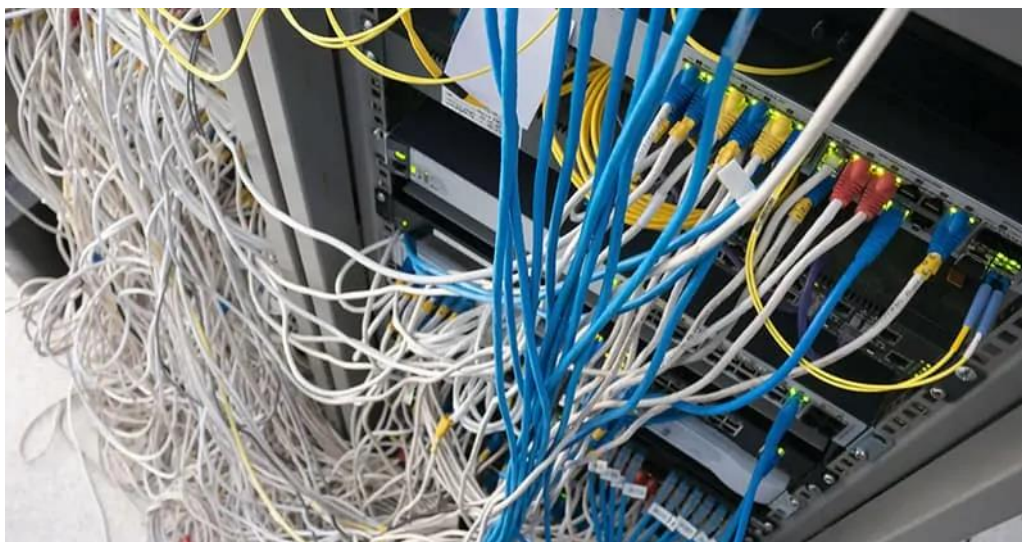
Kuva 10. Esimerkkikuva IT-tilan johtoviidakosta. (AnD Cable Products 2023).
