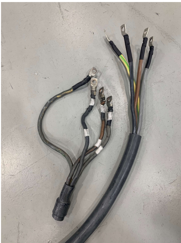
Kuva 22. Vanhat ja uudet moottorin syöttökaapelit
