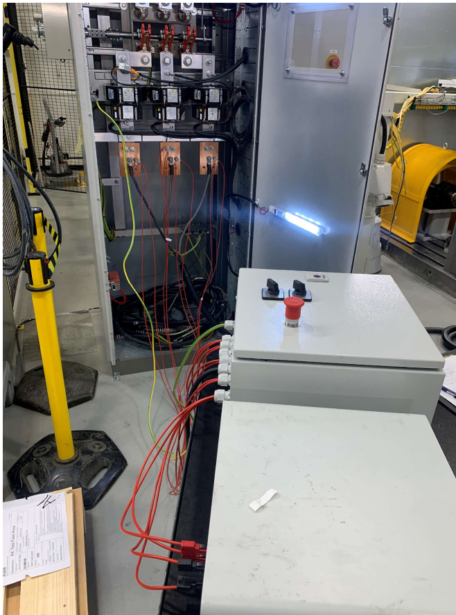
Kuva 20. Resistanssimittaus syöttökaapelin alkupäästä
