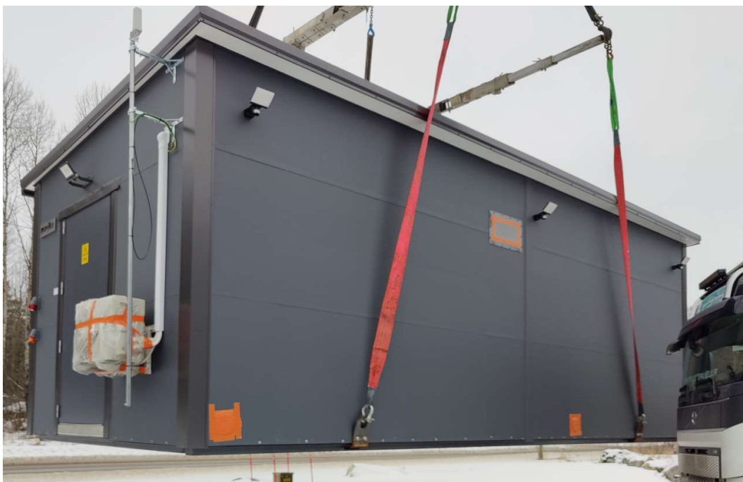
Kuva 2. Aseman ulkopuoliset suojaukset kuljetuksen ajaksi.
