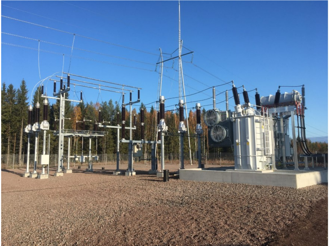
Kuvio 3. Sähköaseman ilmaeristeinen kytkinkenttä (Maviko Oy 2023.)
