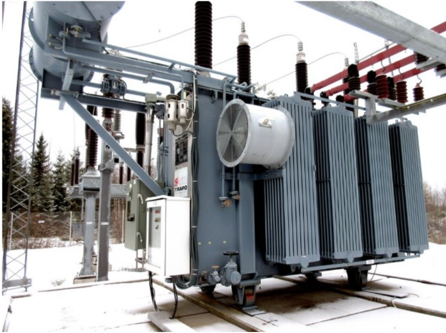
Kuvio 6. Sähköaseman päämuuntaja (JT-Export Oy 2023.)
