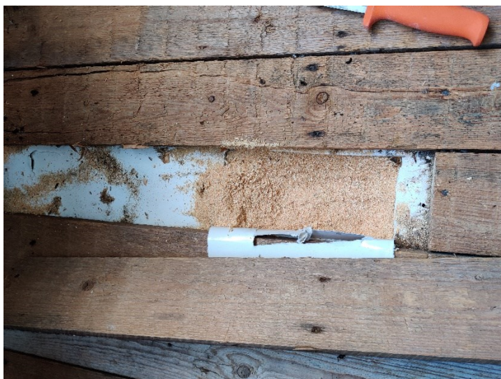
KUVA 10. Välipohjan purut ulkoseinän lähellä ovat säilyneet kuivana.
