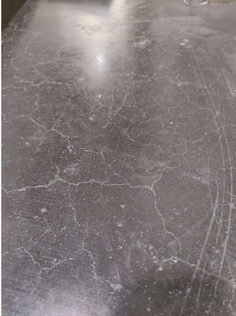
Kuva 4. Plastinen halkeilu betonilattian pinnassa.
