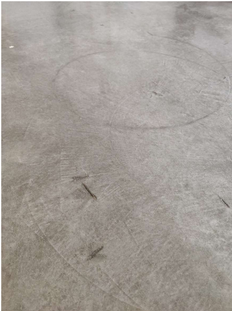
Kuva 7. Kuidun aiheuttamia jälkiä lattiassa.
