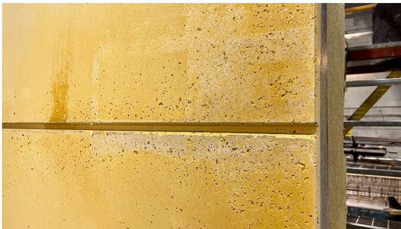
Kuva 11. Ilmahuokosia julkisivuelementin ulkopinnassa.
