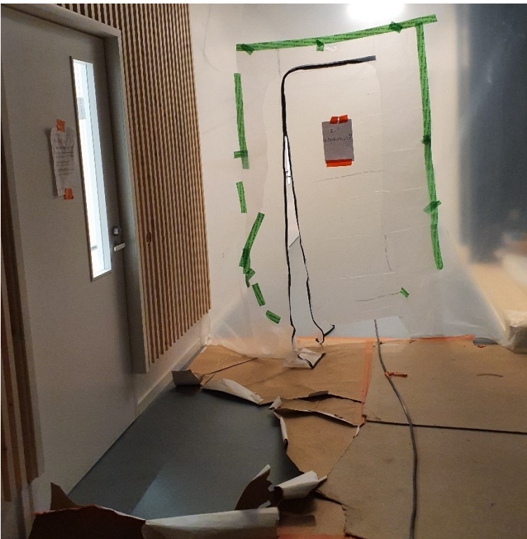
Kuva 10. Epäonnistunut osastointi (P. Rahkonen, henkilökohtainen tiedonanto, 14.4.2023).
