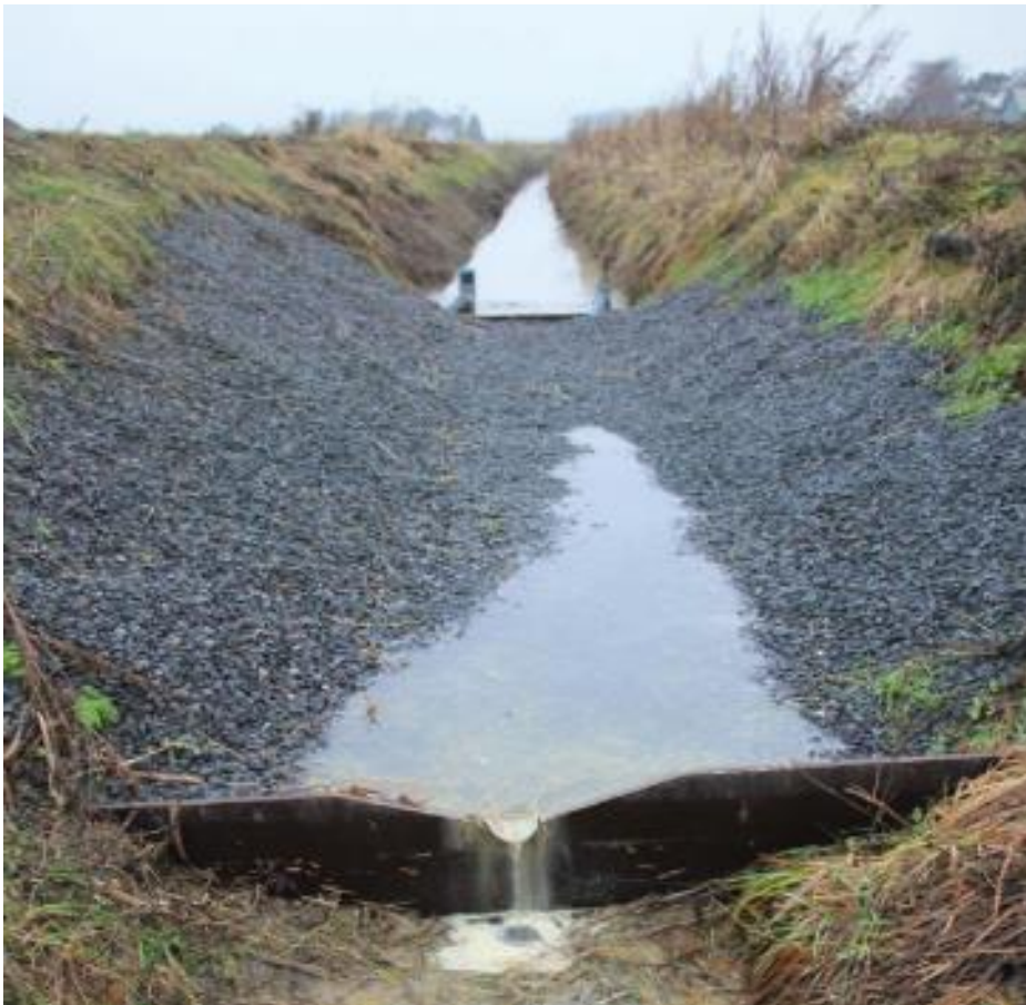
Kuva 15. Esimerkki ojanpohjasuodattimesta (waterchain, n.d.)
