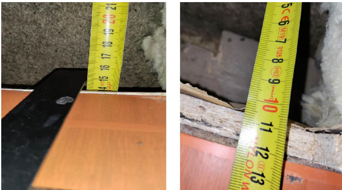
Kuva 13. Alajuoksun alapinta on 20 cm syvyydellä lattian tasosta ja seinärunko on rakennettu 50x100 sahatavarasta.
