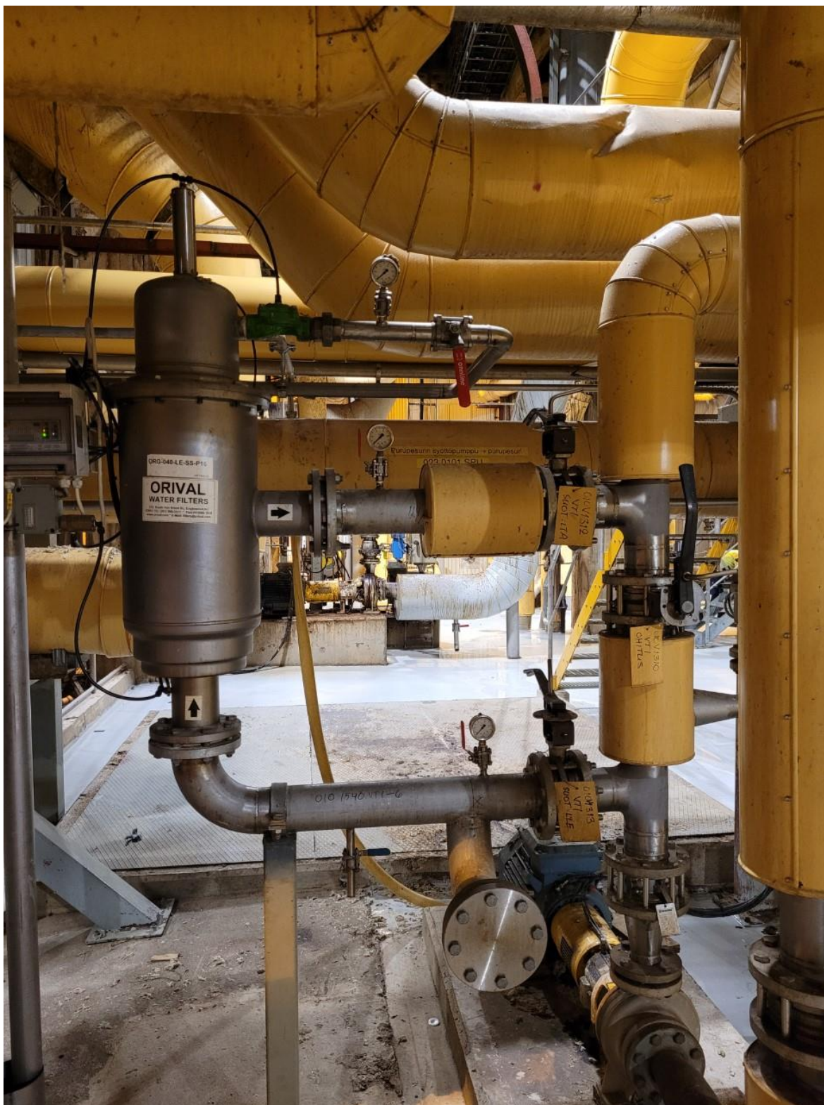
Figur 12. Tätningsvatten filtreringsenhet efter tryckförhöjningspump vid fiberlinje 1.
