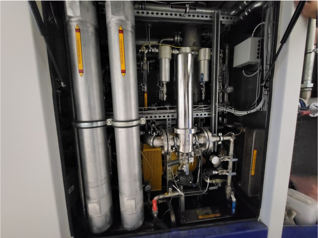
Kuva 7. Membrain-tekniikalla toimiva kaasun puhdistusjärjestelmä.
