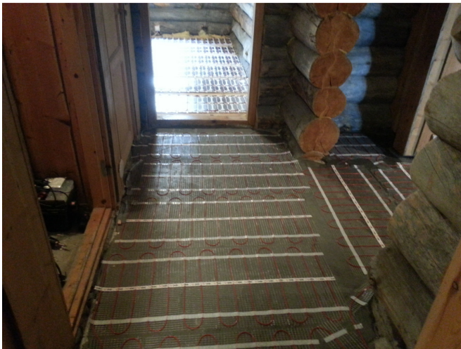
Kuvio 16. Kosteisiin tiloihin asennettu DEVimat.
