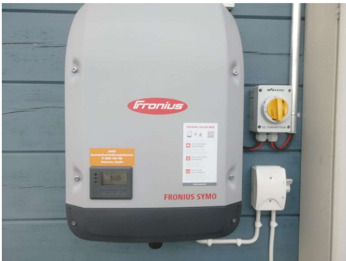
KUVA 6. Ulos asennettu Froniuksen invertteri, jonka oikealla puolella DC-turvakytkin ja virtakytkin (Avitor Sähkö n.d.)
