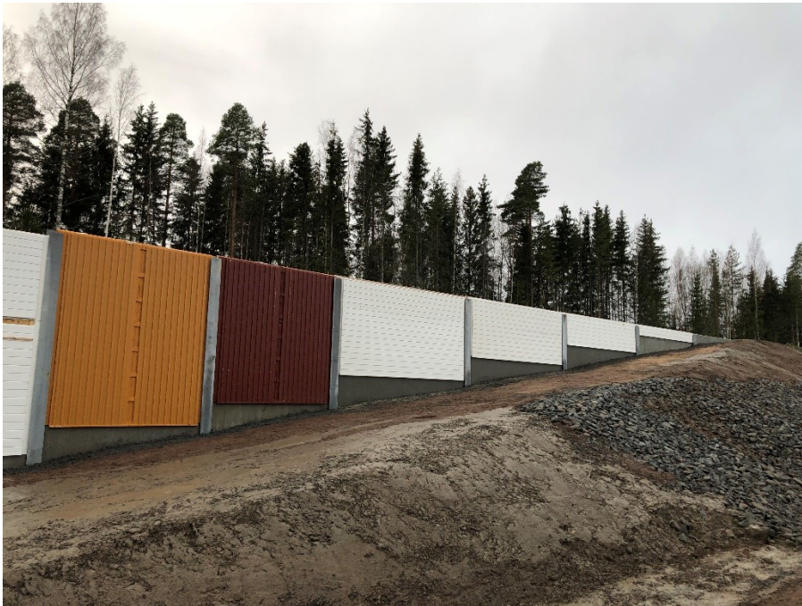
Kuva 3. Meluseinän ja -vallin yhdistelmä Vt3 Hämeenkyrönväylällä.
