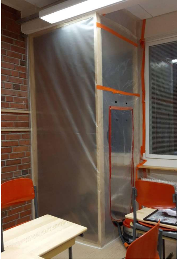
Kuva 15. Suojattu ja osastoitu kastunut alue
