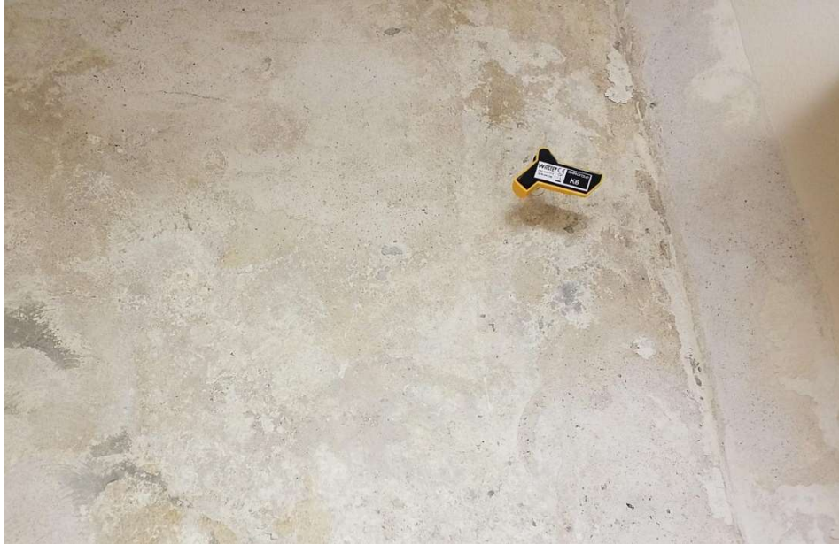
Kuva 17. Etäluettava anturi asennettuna betonilattiassa
