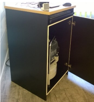
Kuva 12. Kompressori asennettuna tiiviiseen kaappiin.
