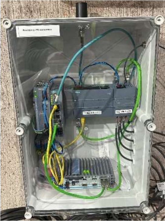
KUVA 20. Tila_1 Kunnonvalvontalaitteisto (Markus Korvela 2023)
