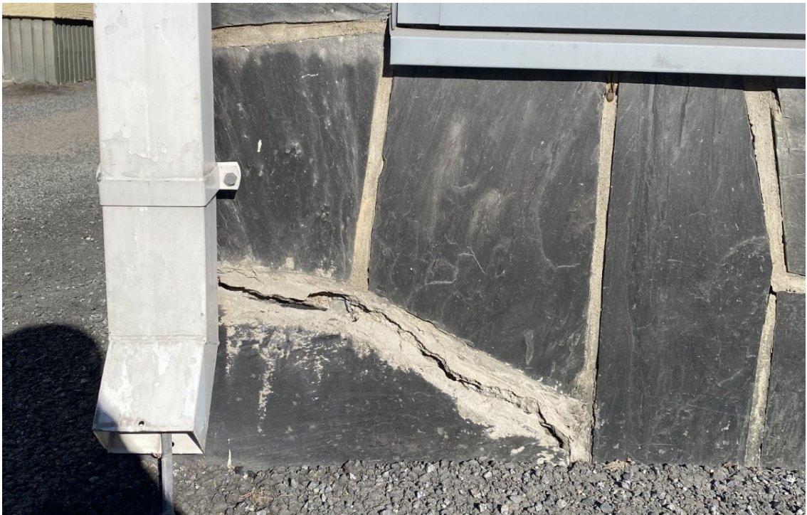
KUVA 50. Irronnut liuskekivi, jota on yritetty korjata huonoin tuloksin. Kivi- laatta sijaitsee paikassa, johon on voinut valua sadevettä ikkunan pellistä ja syöksytorvesta. (Keinänen 2023.)
