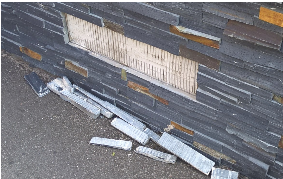
KUVA 51. Irronneita muurinkiviä. Suunnittelija oli valinnut virheellisesti ulkotilaan kivityypin, joka on suunniteltu käytettäväksi vain sisätiloissa. Kiveltä puuttuu tarvittava CE-merkintä, joka kertoisi kiven soveltuvan ulkotiloihin. Tässä tapauksessa vesi on päässyt seisomaan hieman ulostyöntyvien kivien yläpinnalla ja aiheuttanut rakenteen kostumista, joka edesauttaa kivien irtoamista. Seinärakenteen tulee aina päästä kuivumaan ja tuulettumaan, eikä vettä saa tiivistyä kiven takaosaan. (E. Ritola 2015.)
