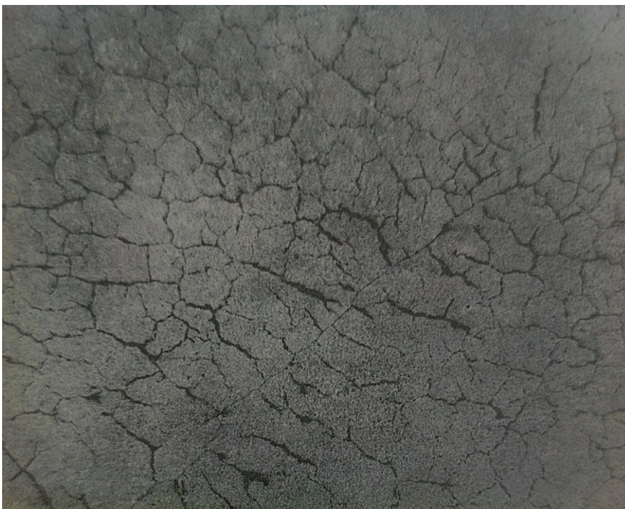
Figur: 20 Typiska plastiska sprickbildningar (Betonilattiat 2023 by 45/ bly 7, 2023) sid. 73
