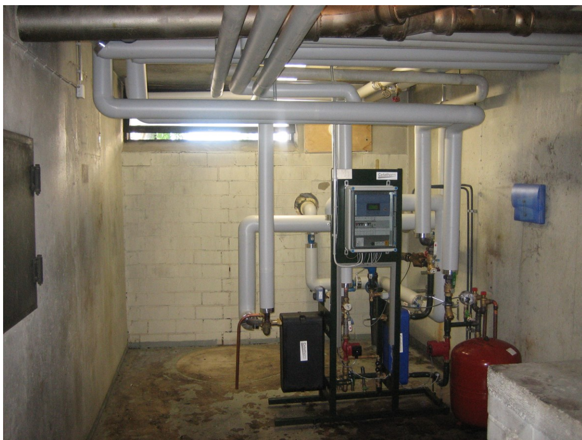
Kuva 7. Tavanomainen kaksipiirinen lämmönvaihdin asennettuna öljylämmityksen tilalle 1973 rakennettuun kerrostaloon. Koulukatu 3, Karkkila.
