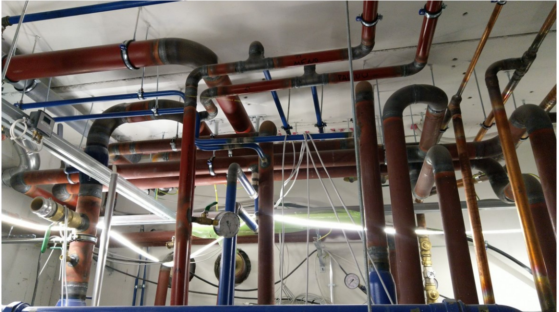
Kuva 10. Valmista putkistoa ennen eristystä lämmönjakokeskuksen yläpuolella. Kohde Runokylänkatu 2 Helsinki.
