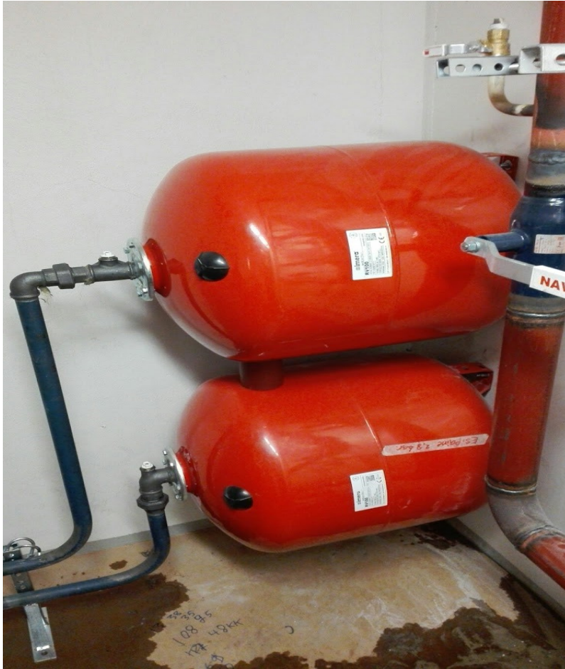
Kuva 11. Kaksi kalvopaisunta-astiaa asennettu päällekkäin lämmönjakohuoneen kulmaan. Kiinnitys seinään pohjasta. Pystyssä oikealla on vielä eristämätön kaukolämpöputki. Kohde Porarinkatu 1, Helsinki.
