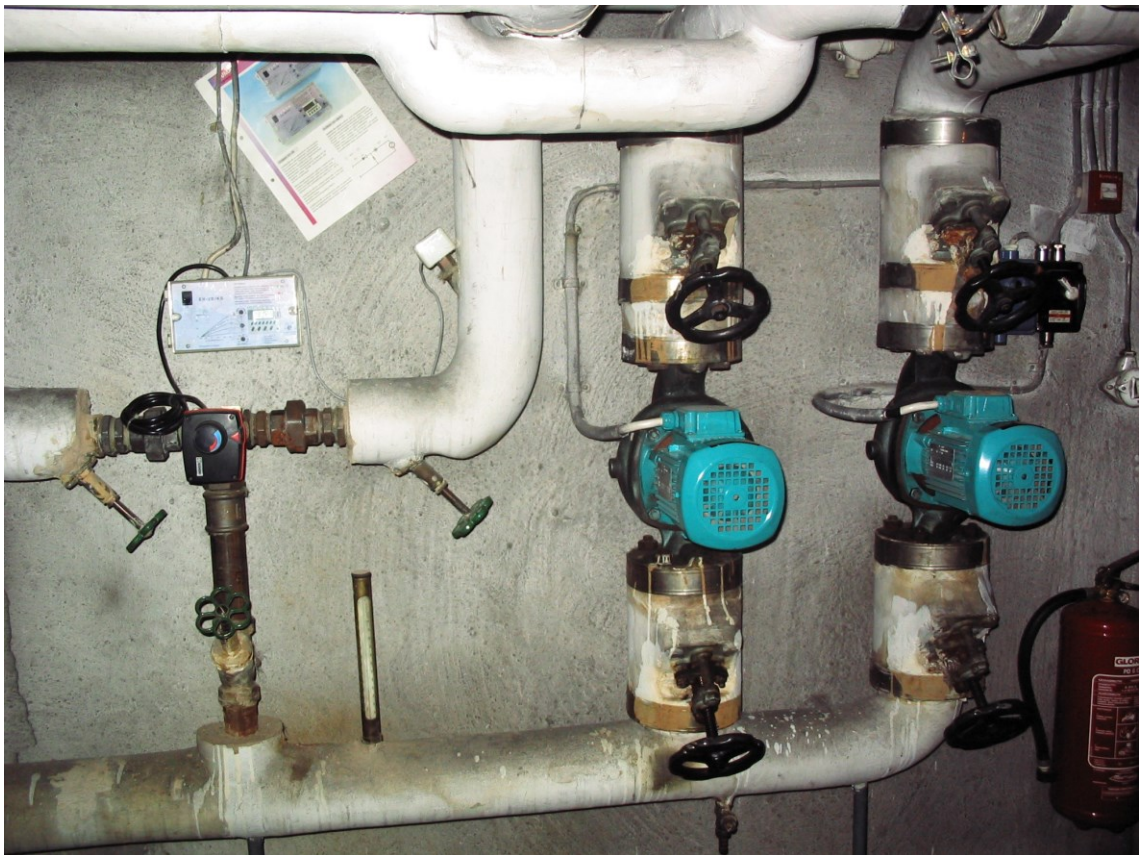
Kuva 8. Asbestilla eristetty putkisto ja pumppuryhmä seinällä öljylämmityskohdeessa. Kohteeseen asennettiin kaukolämpö vuonna 2005. Asbestit purettiin asianmukaisesti ennen mitään töitä. Kohde Linnunuitonkatu, Karkkila.
