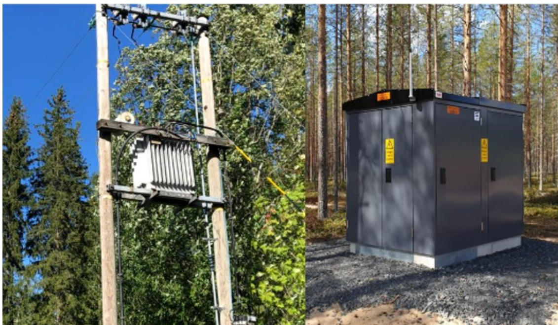
KUVA 5. Pylväs- ja puistomuuntamot 20 kV / 400 V (Elenia, 2023)
