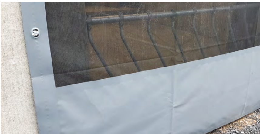
Kuva 33. Pressuovi tuuliverkolla. Tuuliverkon ansiosta ulko-ovi toimii hengittäväenä rakenteena ja lisää luonnon valon määrä sisäpuolella. Kuva NHK-Keskus
