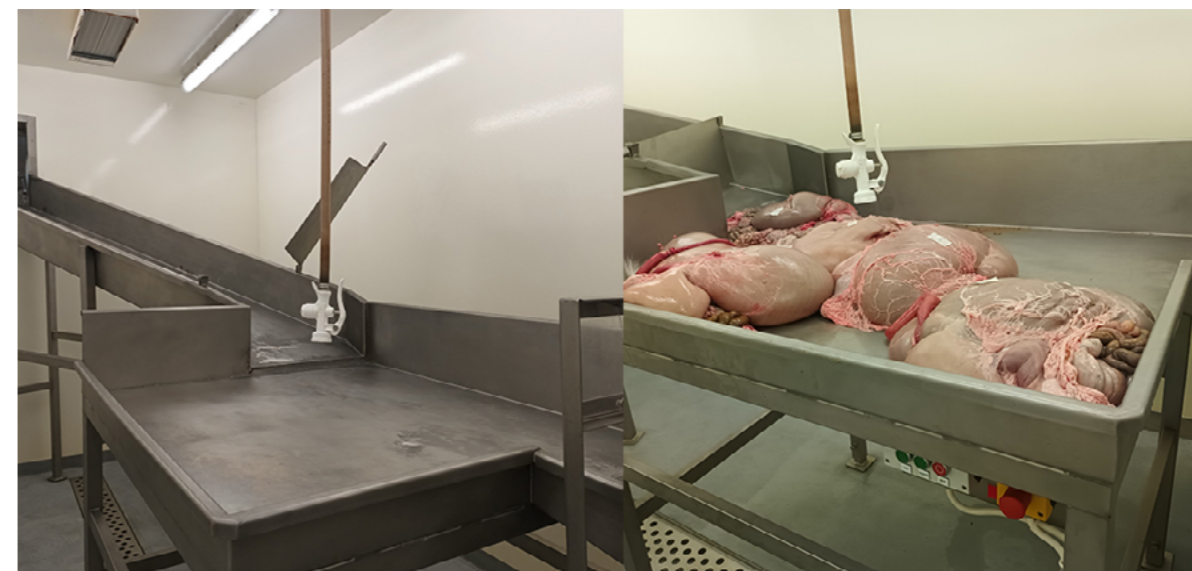
Kuva 1. Sisätiloihin sijoitettu maha-suolikouru Toivoniemen teurastamolla. Kourussa on käsikäyttöinen säädin, jolla kourun voi tarvittaessa sulkea niin, ettei käsittelypöydälle kerry liian paljon tavaraa. (PoSiHIILI-hanke).
