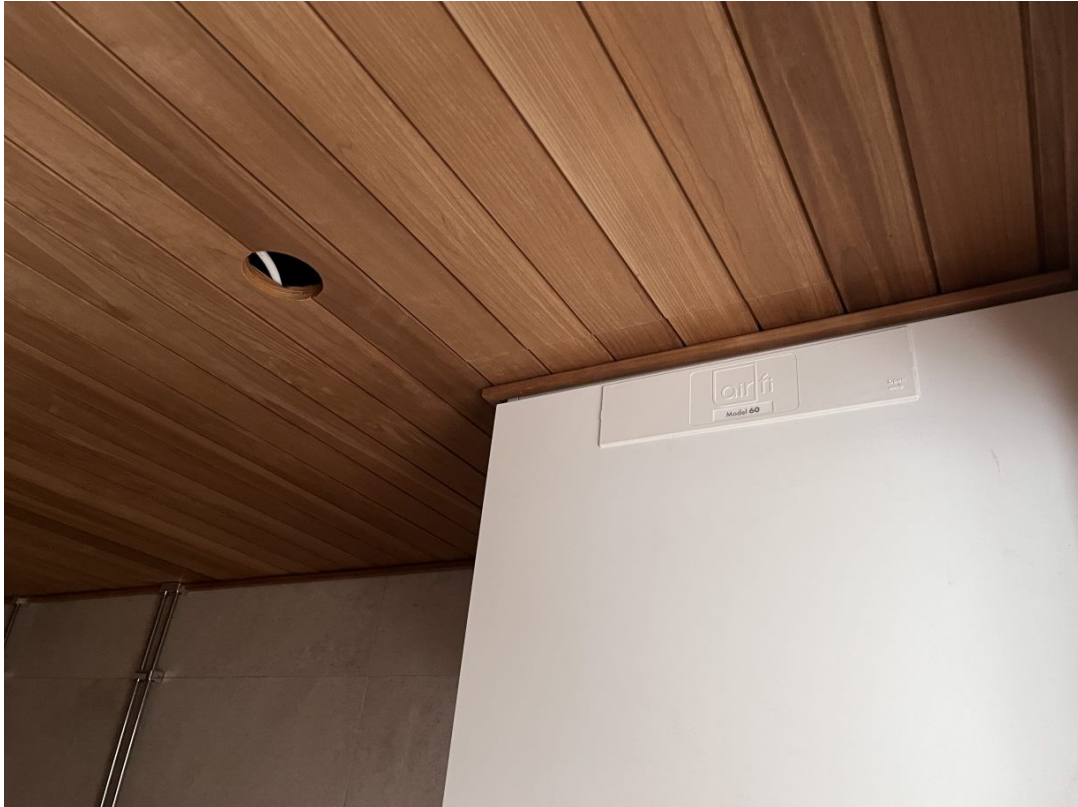
Kuva 15. Ilmanvaihtokoneen runko asennettiin sellaiseen korkoon, että katkaiset paneelit saadaan piiloon listan avulla.
