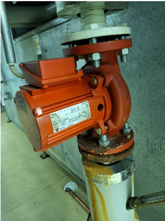
Kuvio 31. TK01 lämmityspatterin kiertovesipumppu.
