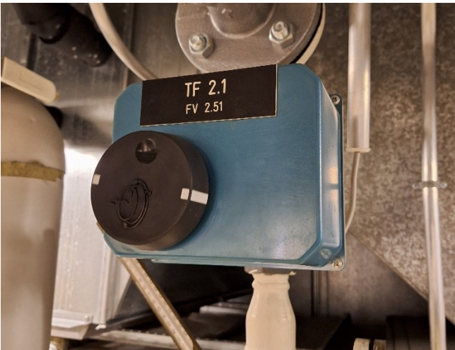
Kuvio 36. TK02 lämmityspatterin venttiili FV 2.51 soutaa.
